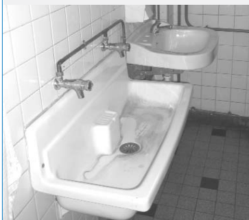
Sanitaires délabrés du centre de loisirs Villeneuve
